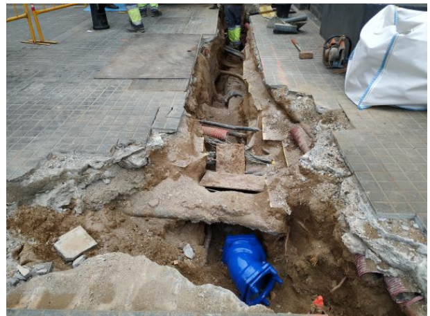
4. Vista de la rasa amb els serveis actuals al carrer de Sant Pau.
