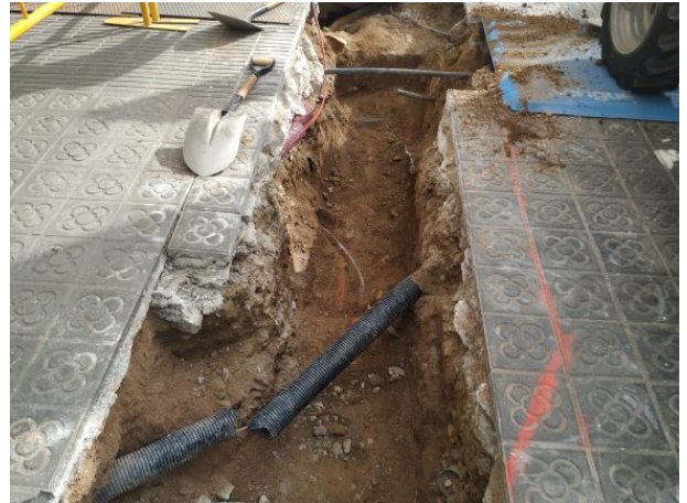
10. Vista de la rasa amb serveis i fonamentació de l'edifici al carrer de la Mercè.
